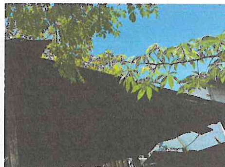
Foto 2: Sustrucción de lámina por deterioro en cocina
