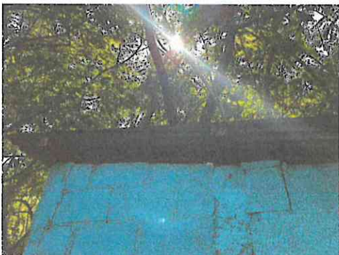
Foto 1: Sustrucción de lámina por deterioro en baños
