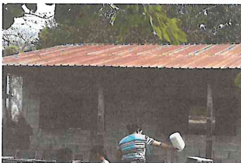
Foto 5: Sustrucción de lámina por deterioro en 2 salones
